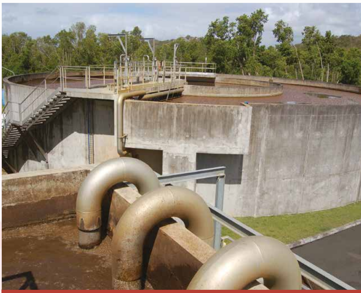
Figure 22 : Station d'épuration de Montauban Gosier (source : Office de l'Eau)
